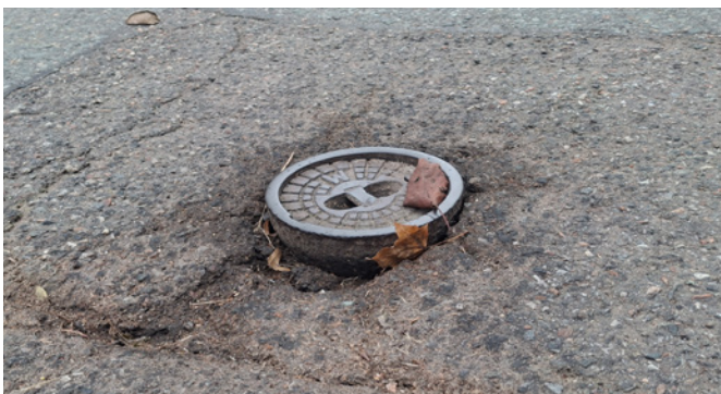
Bild 1: Setzung im Bereich von Straßenkappen
